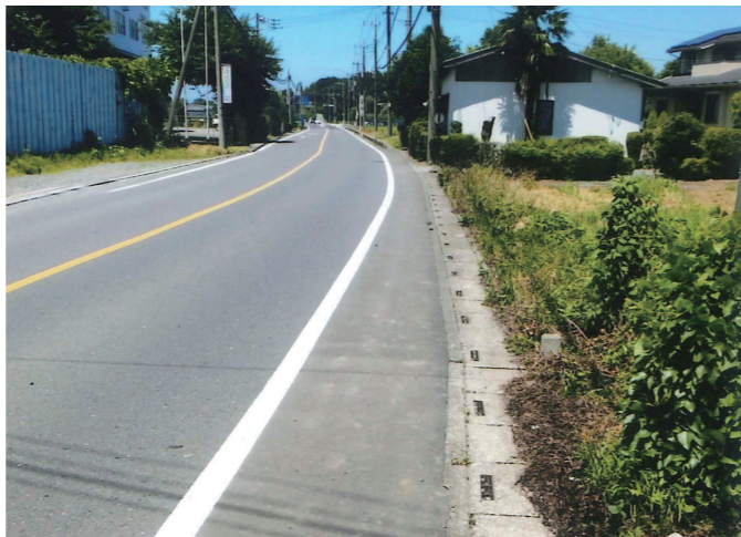
高虫デサン(株) 前歩車道境界ブロックがない箇所
